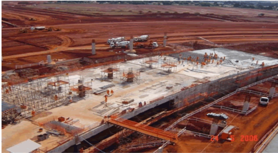
Concretagem da Primeira Laje do Piso do Pavimento Térreo do Terminal de Passageiros do Aeroporto de Goiânia
